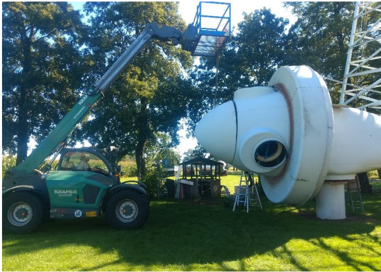
Aufbau der Gondel einer Enercon E-40 5.40
